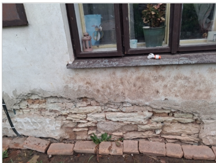
Foto: Nefunkční oplechování parapetu
