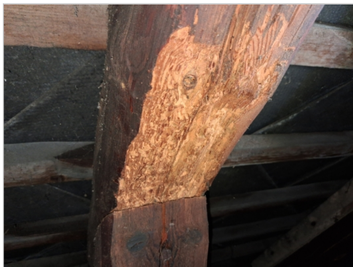
Foto: Degradace krokve u napojení podpěry
