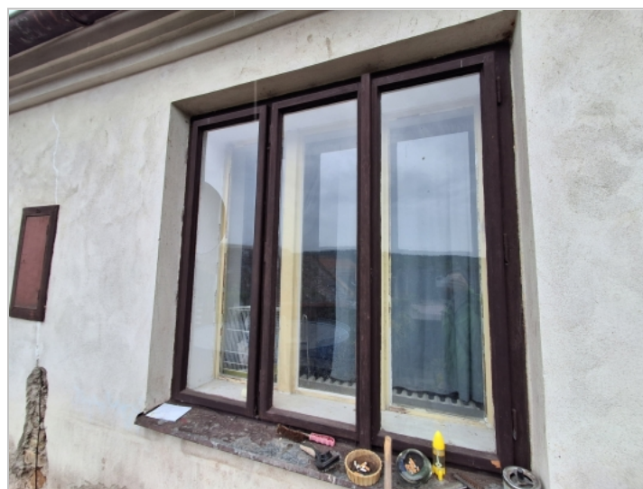
Foto: Rozbité zasklení vnějšího rámu
