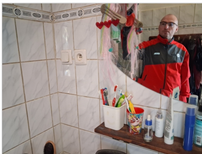
Foto: Zásuvka mimo umyvadlovou zónu
