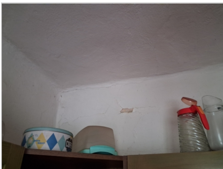
Foto: Trhliny v místě styku stropní a svislé kce.
