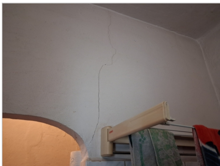
Foto: Trhliny v místě oslabení otvory
