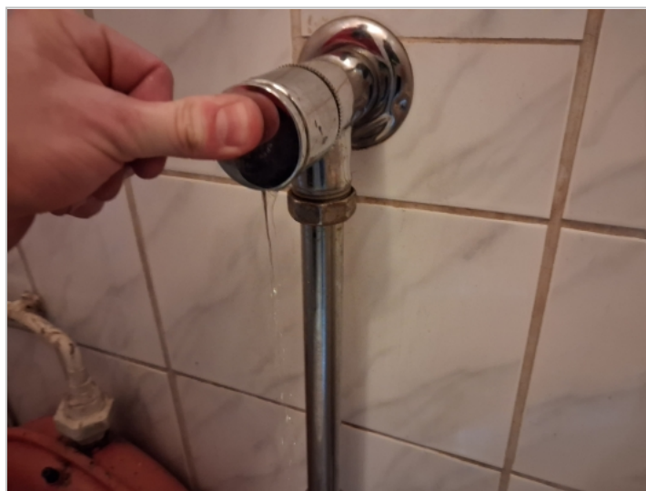
Foto: Protékající armatura
