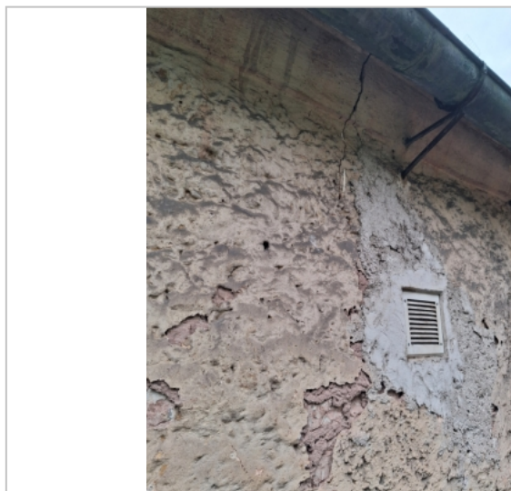
Foto: Větrací mřížka na severní fasádě
