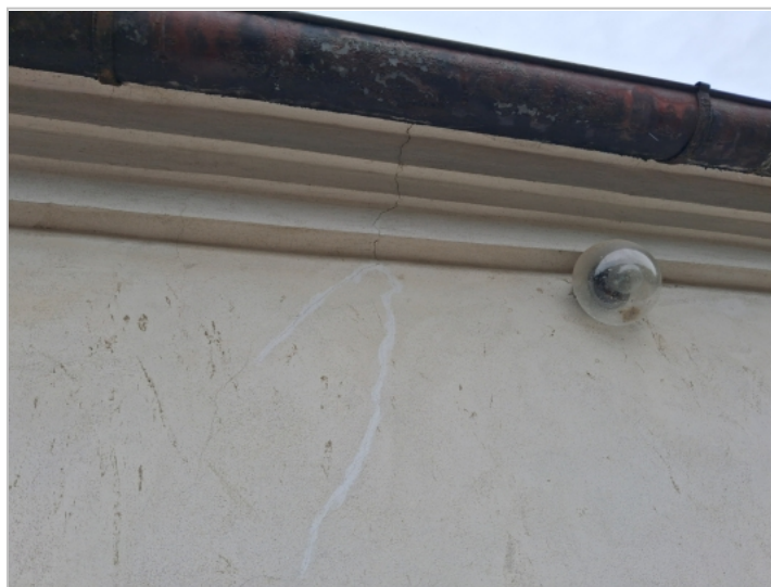
Foto: Trhliny ve svislých konstrukcích
