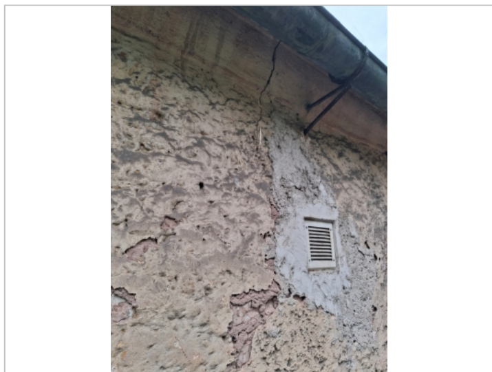
Foto: Trhliny ve svislých konstrukcích
