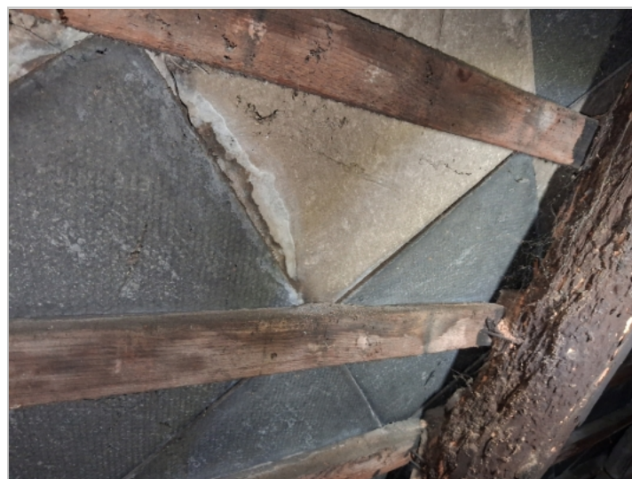
Foto: Poškozená krytina
