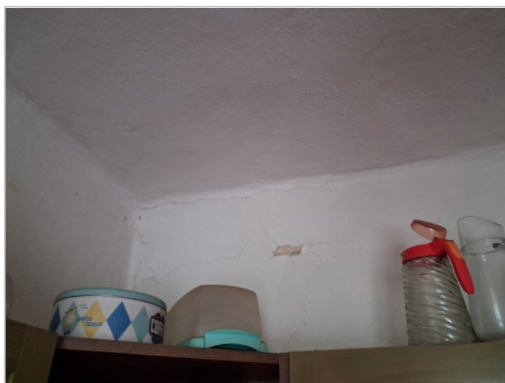
Foto: Trhliny ve vnitřních povrchových úpravách
