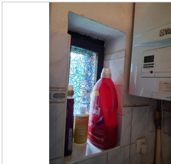
Foto: Přívod plynu ke kotli
