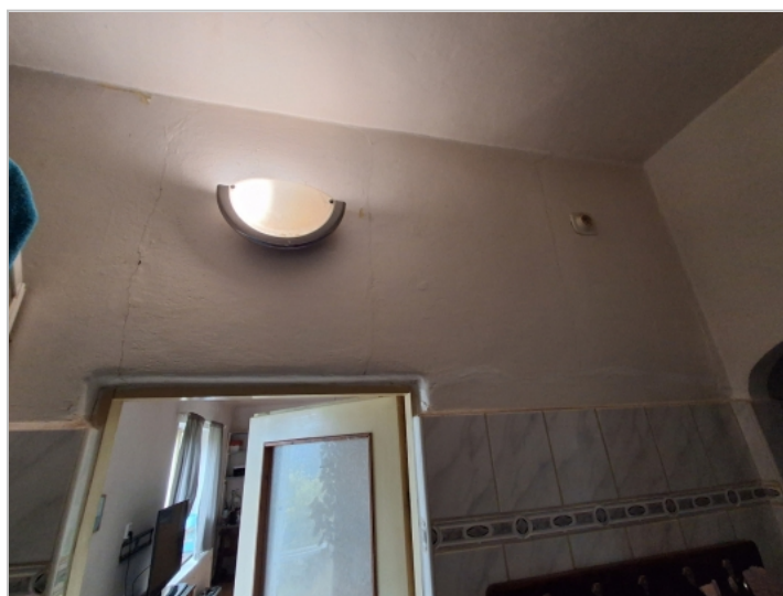
Foto: Trhliny v místě oslabení otvory
