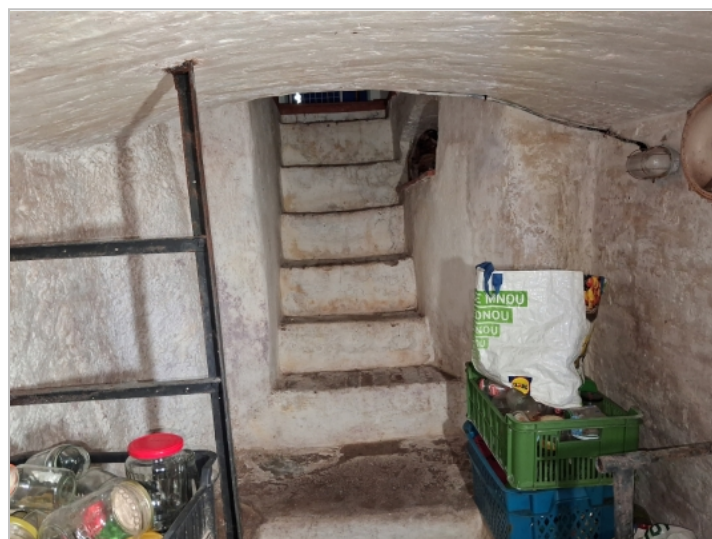
Foto: Klenutá část stropu sklípku
