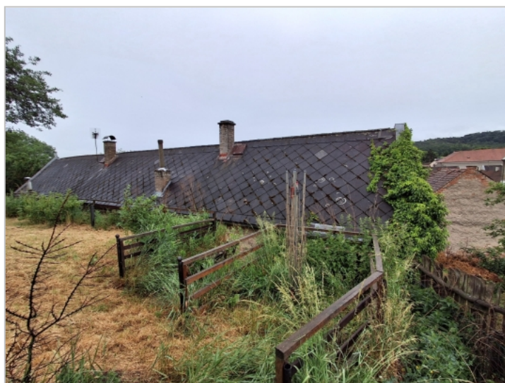
Foto: Absence hromosvodu
