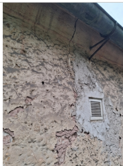
Foto: Trhlina v sev. fasádě
