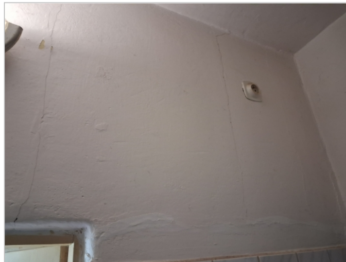
Foto: Trhliny ve vnitřních povrchových úpravách
