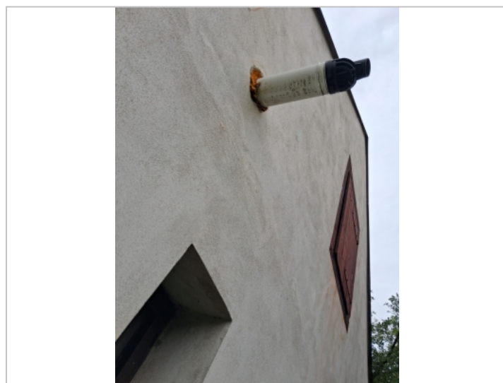
Foto: Odkouření plynového kotle
