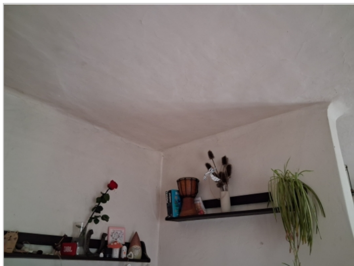
Foto: Trhliny v místě styku konstrukcí
