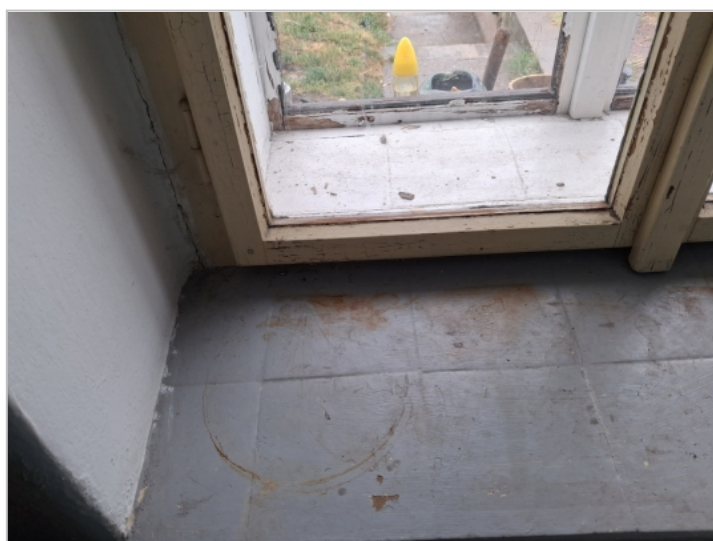
Foto: Vnitřní parapet poškozeného okna
