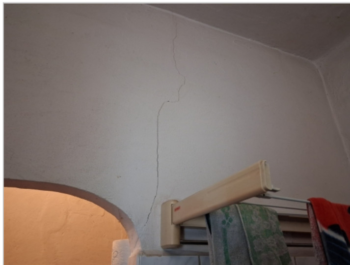
Foto: Trhliny ve vnitřních povrchových úpravách
