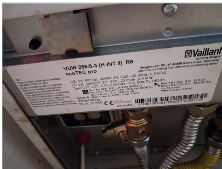
Foto: Plynový kotel
