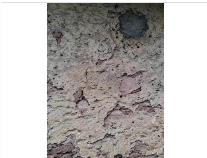
Foto: Trhliny na severní fasádě
