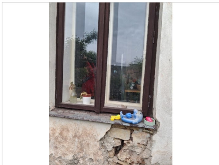
Foto: Nefunkční oplechování parapetů
