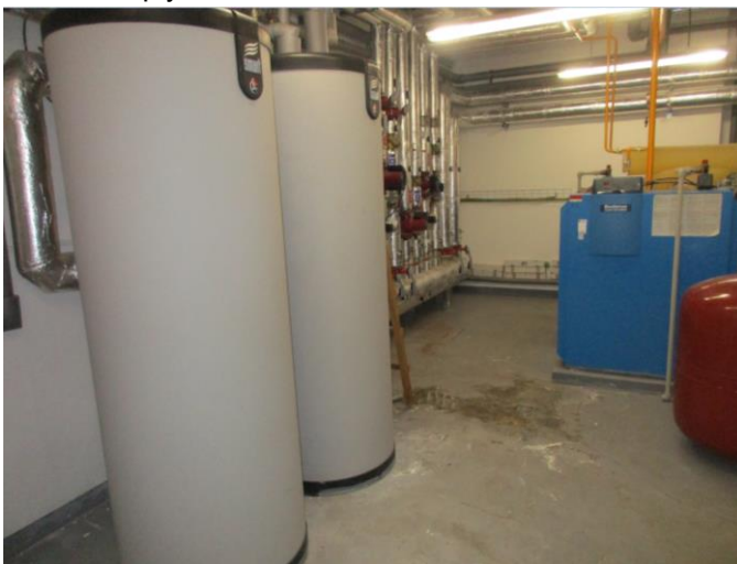
Foto č.4 – plynová kotelná, kotle Buderus
